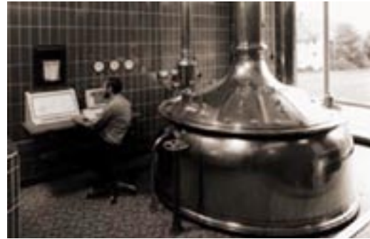
Brauer am Werk: Alois Gmür steuert die traditionell-moderne Brauanlage in Einsiedeln.
